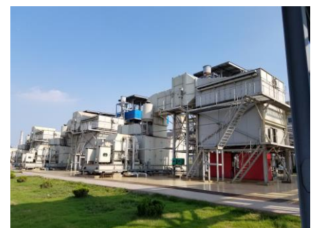
燃机四期项目实景图
