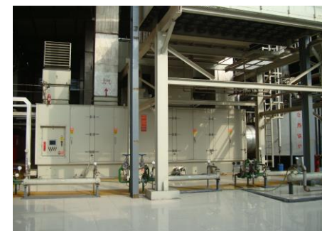
燃机三期项目实景图
